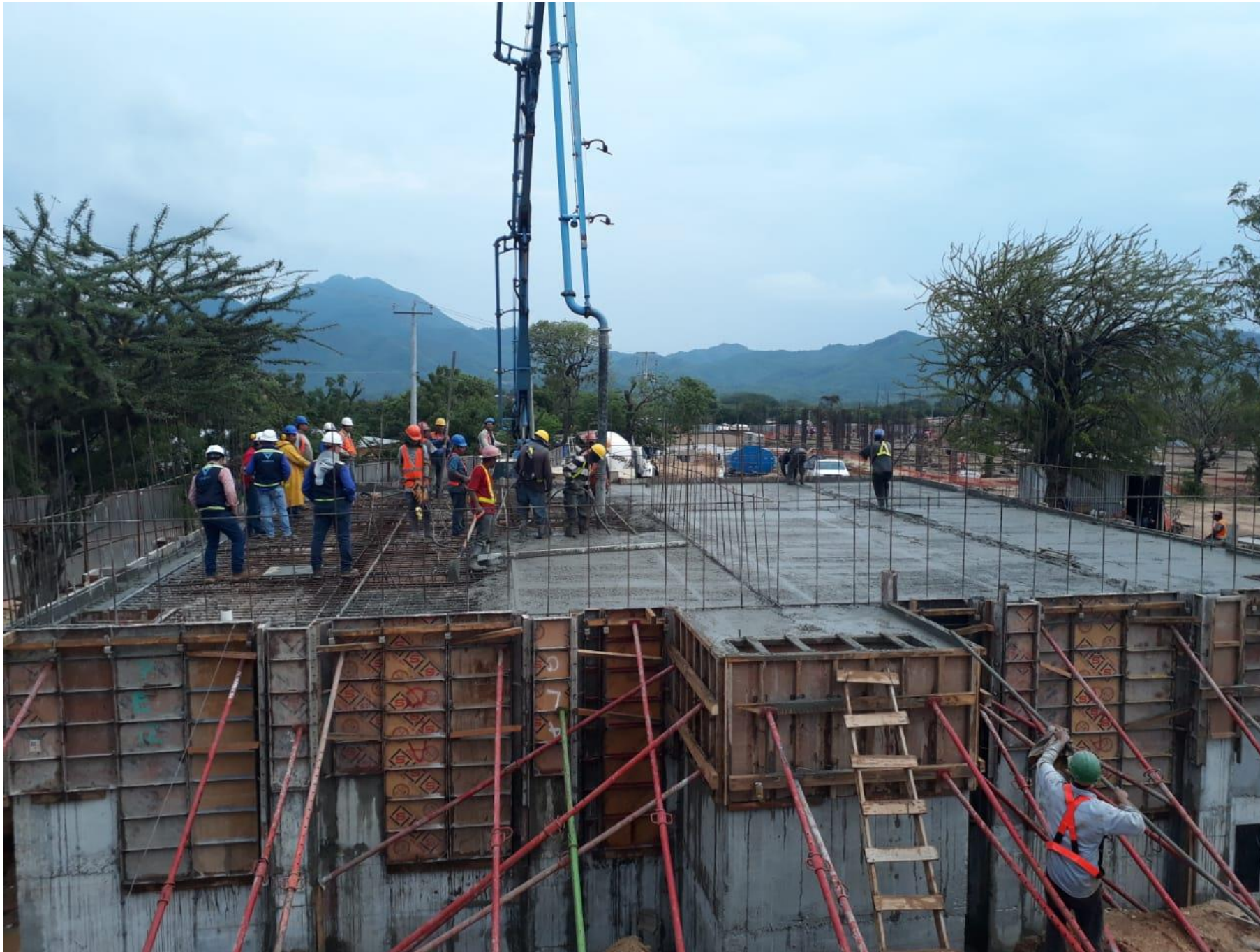
Cisterna de agua potable.
